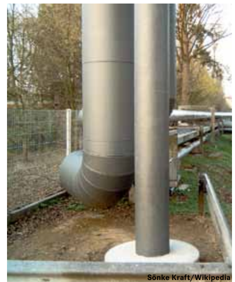
Fernwärmefreileitungen in Hameln
